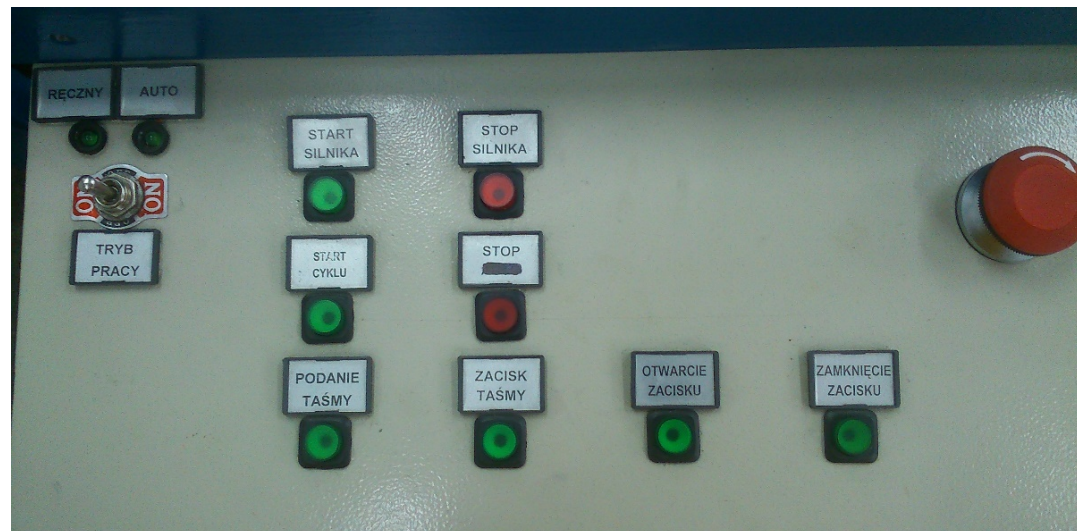
Rys. 9. Panel sterujący znajdujący się na górnej ścianie szafy sterowniczej
